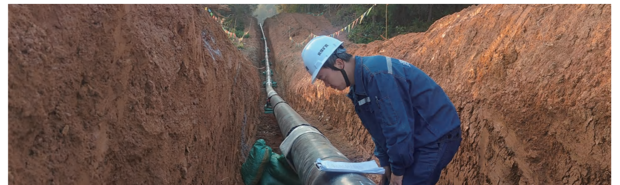
“涪瓮线”3号阀室至余庆输气管道
